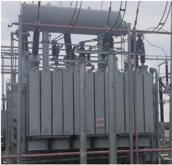
3号主变（本期扩建）
