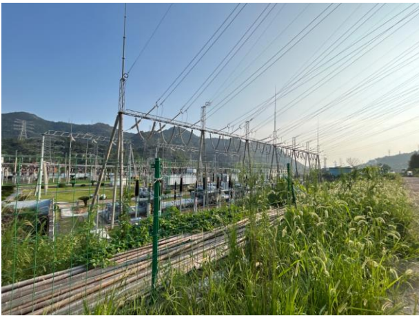
220kV 童燎变电站扩建间隔侧
