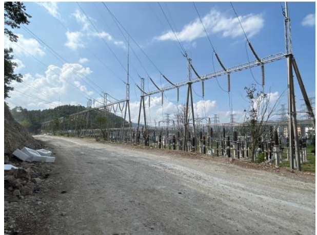
220kV 悬渚变电站扩建间隔侧
