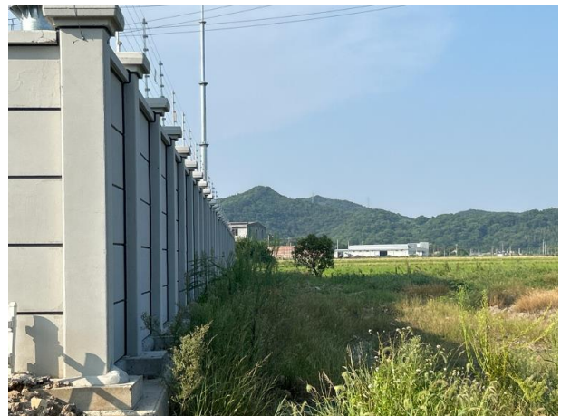
变电站东南侧
