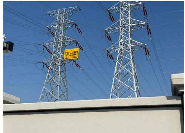
变电站危险标识
