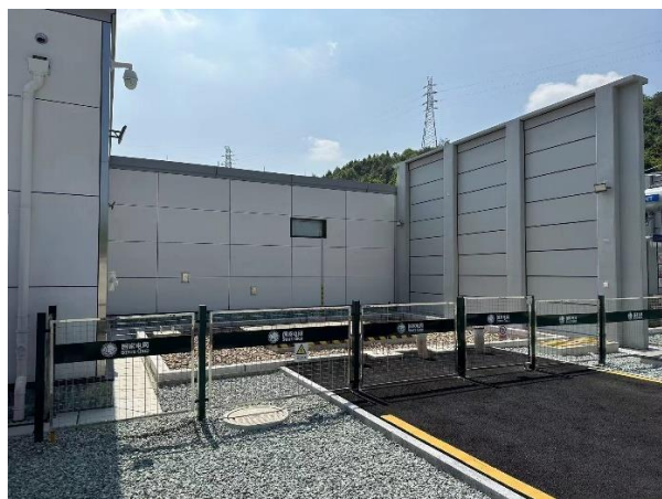
3号主变预留场地
