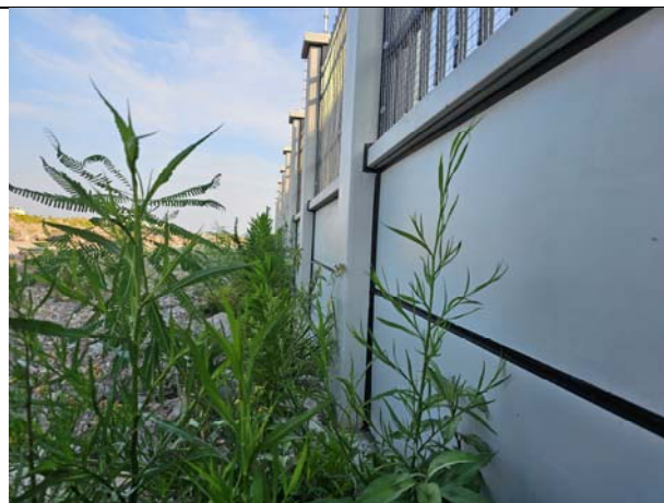
变电站东南侧
