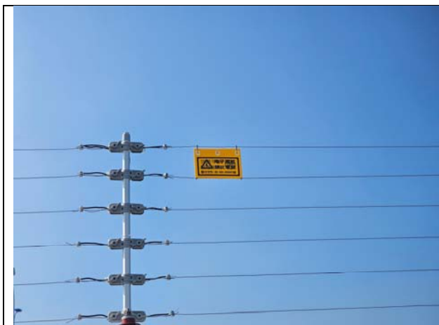
变电站警告标识
