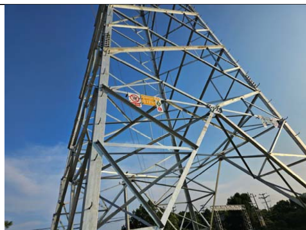
塔基警告标识
