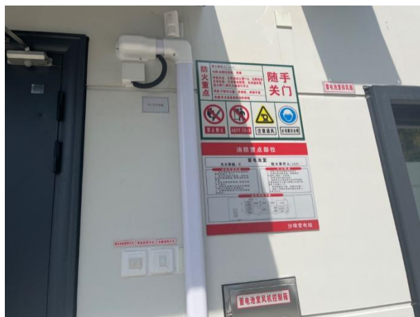
变电站警告标识 2
