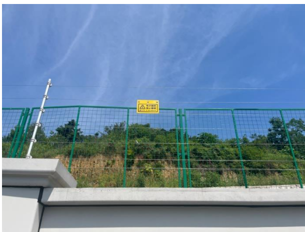
变电站警告标识 1
