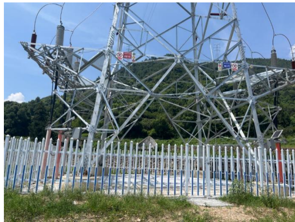
电缆终端塔基现状
