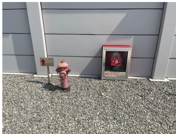
站内消防设施 2
