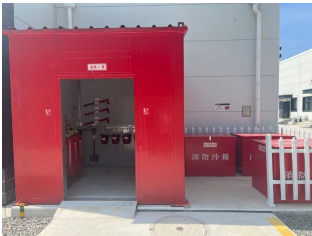
站内消防设施 1
