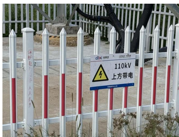
电缆终端塔围栏及警告标志
