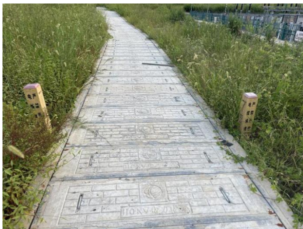
电缆线路警示标志（2）
