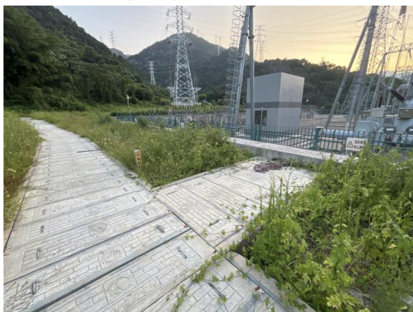
电缆接入变电站侧（1）
