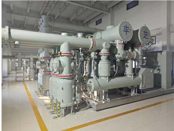
图 4-11 220kV 户内 GIS 室
