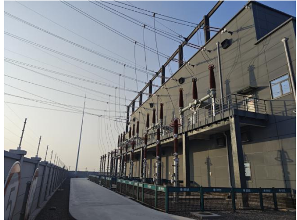
图 4-6 220kV 出线间隔
