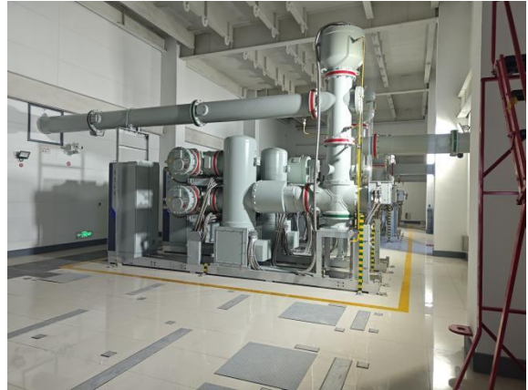
图 4-12 110kV 户内 GIS 室
