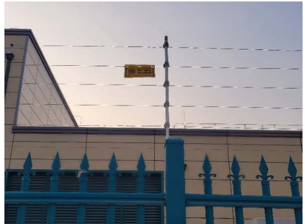
变电站警告标识
