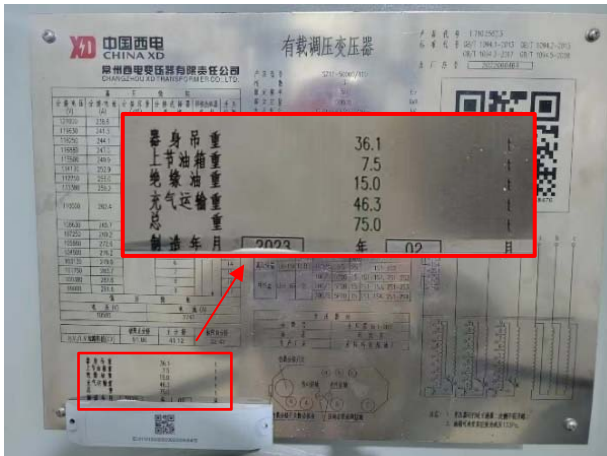
1#主变铭牌（绝缘油重 15t）
