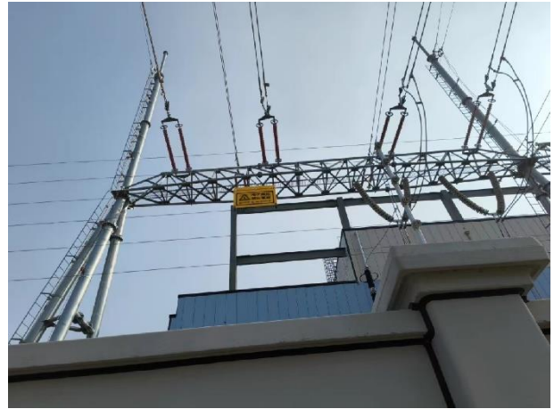
珊瑚 220kV 变电站扩建间隔警告标识
