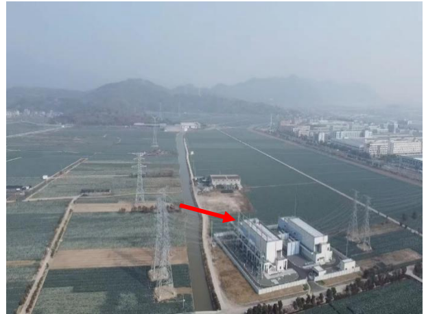
220kV 架空线路接入 220kV 珊瑚变电站
