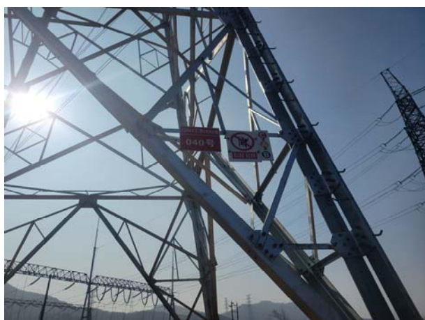
塔基警告标识
