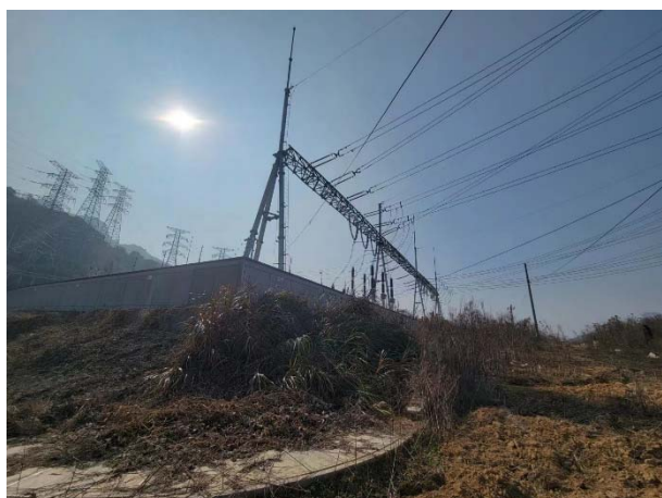
琴江 220Kv 变电站间隔扩建侧现状
