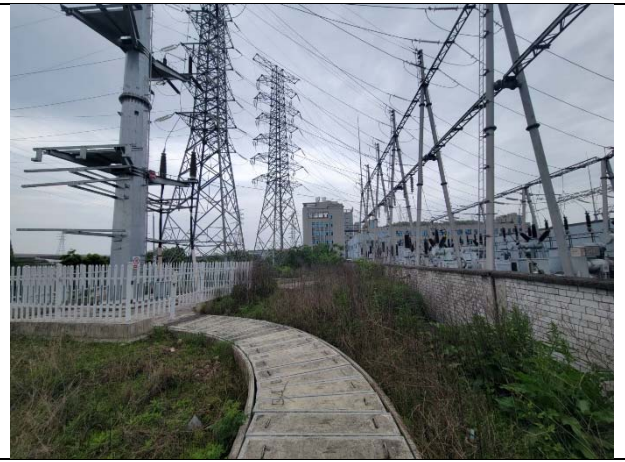
间隔扩建侧现状
