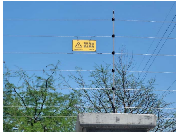
变电站警告标识
