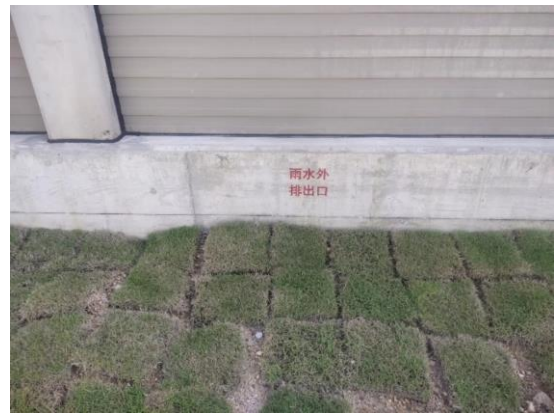
雨水外排出口
