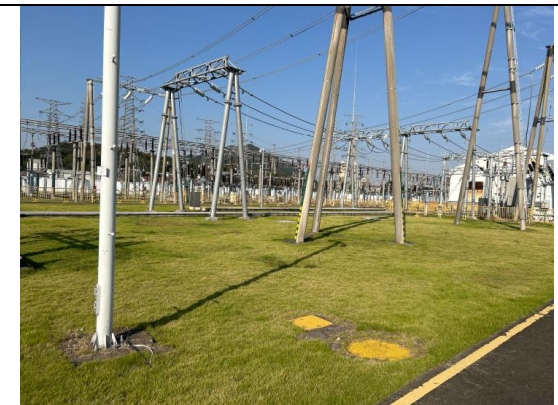
4 号主变预留场地
