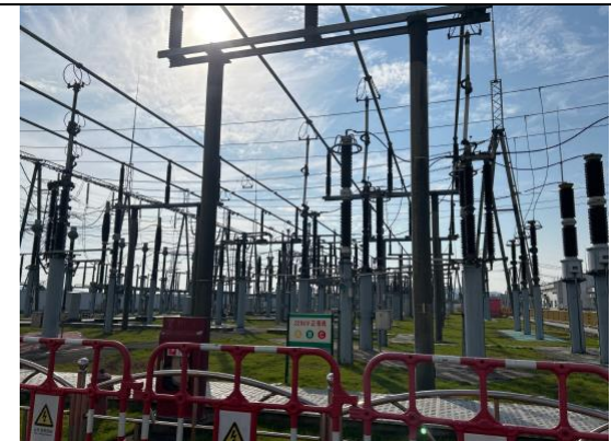
220kV 配电装置
