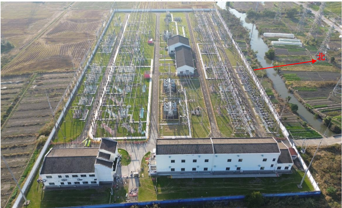
图 2-2 变电站现状俯视照片
