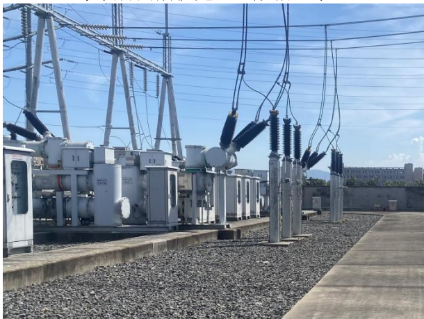
110kV 配电装置区
