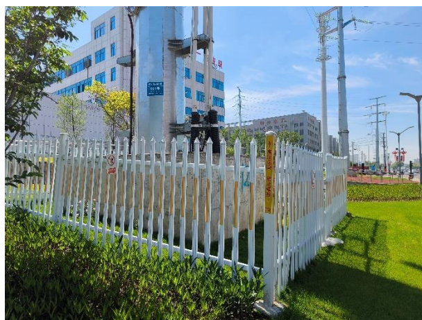
110kV 象三塘 1214 线#1/110kV 象盐海 1215 线#11 电缆终端塔
