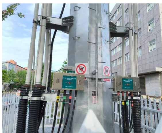
塔基警告标识 2
