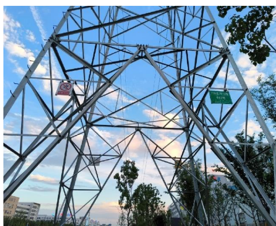
塔基警告标识 1
