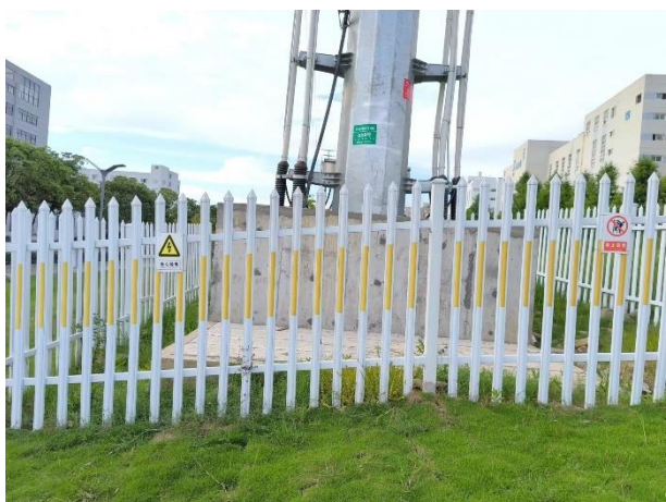
110kV 象自 1219 线#38/110kV 三创 1742 线#1 电缆终端塔
