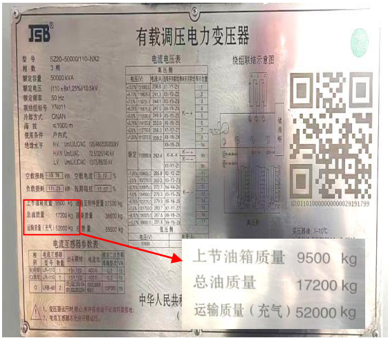
1#主变铭牌（油重 17.2t）
