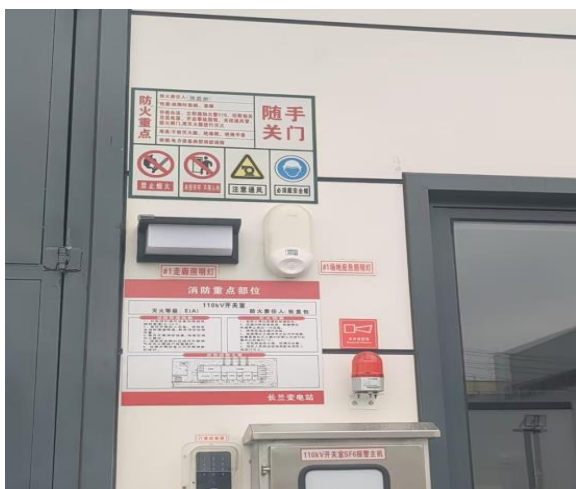
变电站内危险标识 1
