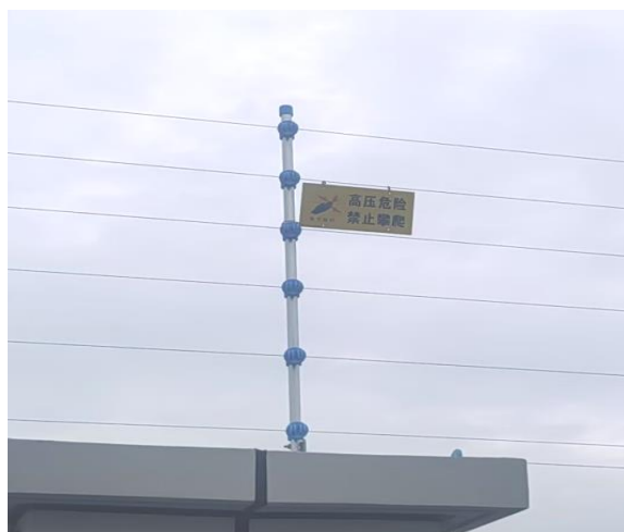
变电站内危险标识 2
