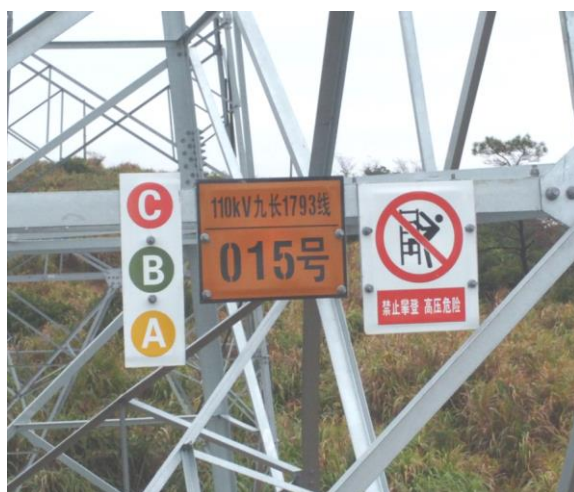
塔基危险标识 2
