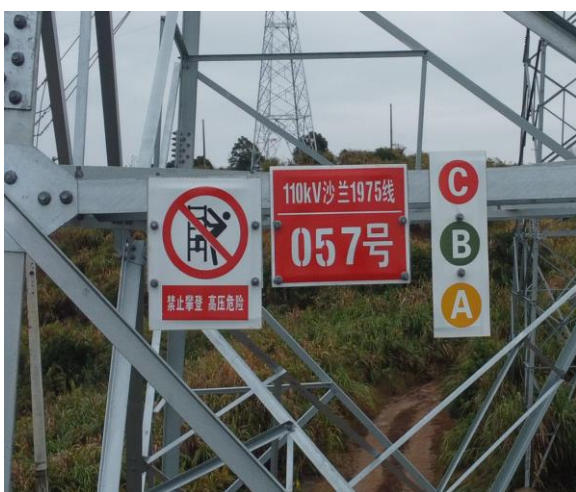
塔基危险标识 1
