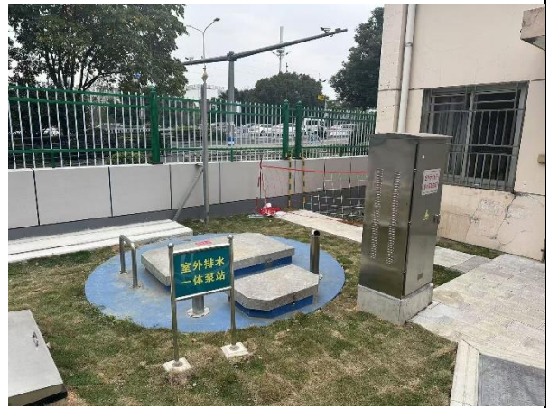
室外排水一体泵站
