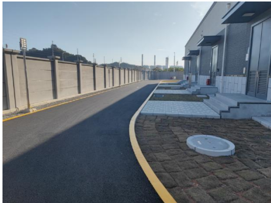
110kV 出线侧区域
