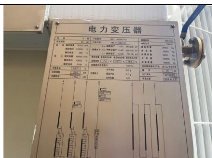
1 号主变铭牌（油重 18.9t）
